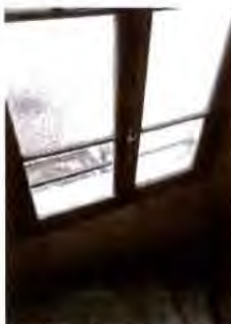
Photo 4 : Volée R+2 à R+3 - Fenêtre
