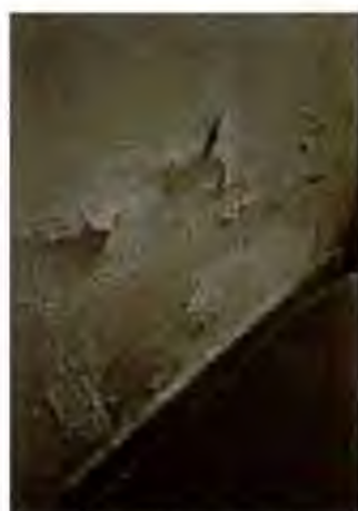
Photo 3 : Palier R+3 - Couloir droite - Mur
