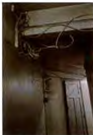
Photo 2 : Palier R+4 - Fils électriques.
