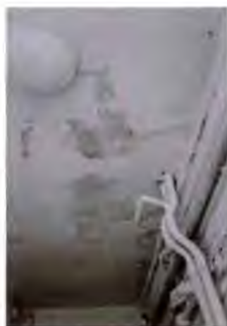
Photo 1 : Palier R+5 - Plafond
